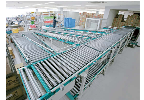
連続して2ヶ所で入庫作業が行えるコンベヤ式の ピッキングステーション。
