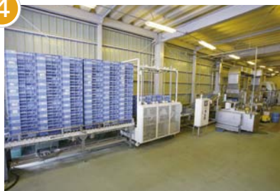
空クレート洗浄エリア
