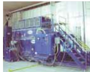
粉体塗装設備
