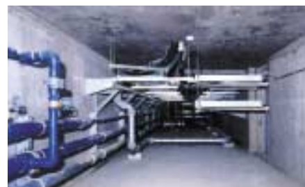
中井サイトの地下トレンチは、点検が容易なため、事故を未然に防止。また、万一有害物質が漏洩した場合でも地下トレンチ内でとどまるため土壌汚染を発生させない
